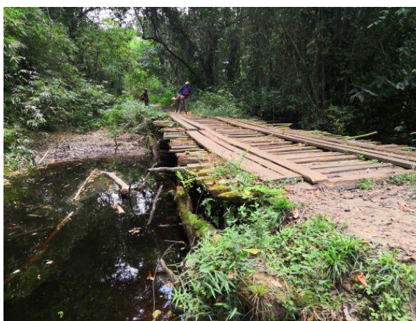
Pont Nzali-Dwama à reconstruire
