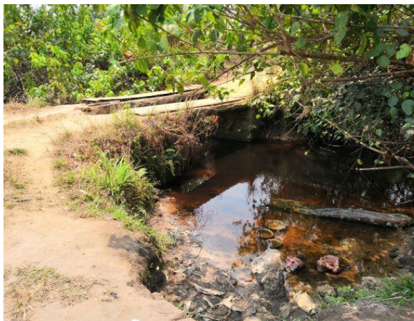
Pont Liduma à reconstruire
