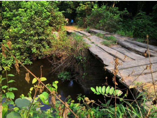
Pont Mokaba 1 à reconstruire en béton armé
