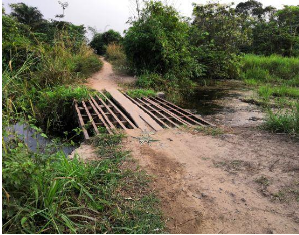
Pont Buku buku 2 à reconstruire en béton armé
