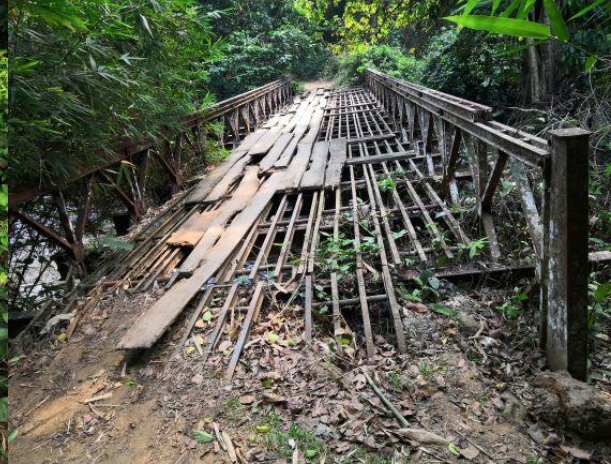
Pont métallique Mbale 1 à réfectionner
