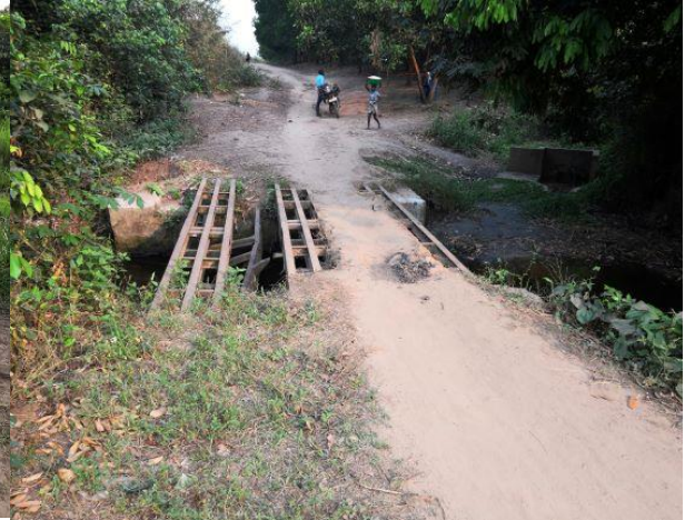
Pont Musakariya à reconstruire en béton armé
